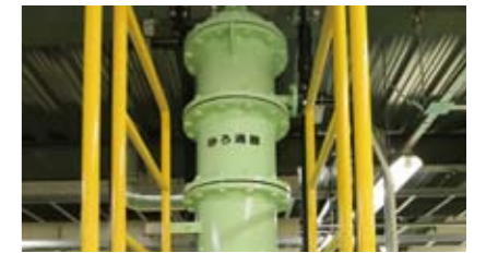
砂ろ過器 処理水中のSSを砂ろ過器にてろ過し、さらに良質な水質にします。
