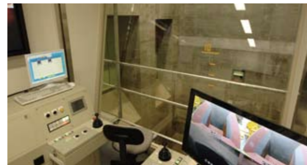
ごみクレーン操作盤
