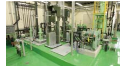
凝集沈殿処理設備 浸出水中に含まれる重金属類やSSを沈殿分離除去します。
