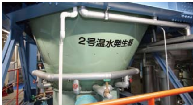
温水発生装置
