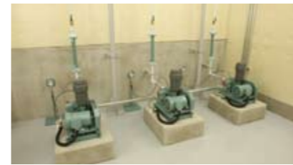
流入調整設備 ブロウ空気による空気攪拌を行い、浸出水の腐敗防止を図るとともに、水質の均一化を図ります。
