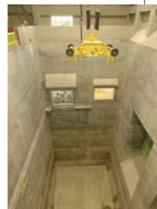
ごみピット ごみピットに溜められたごみを、ごみクレーンで攪拌した後、ごみ投入ホッパへ投入します。
